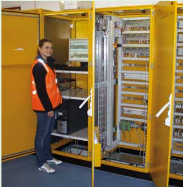
Eine Technikerin beim Steuern der Signalisation des Uetlibergtunnels ab der Tunnelzentrale ...
