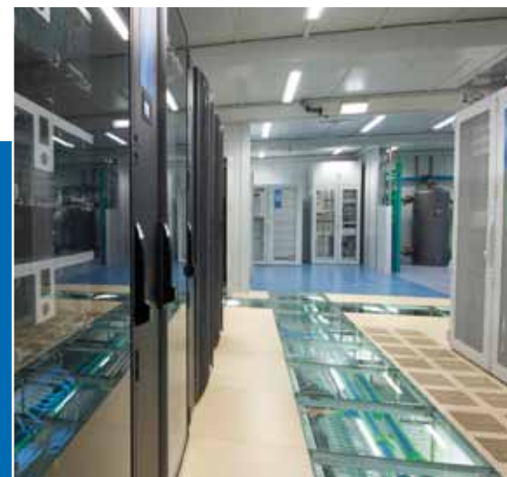
Hersteller wie Rittal entwickeln die Infrastrukturen für effiziente, sichere und hochverfügbare Rechenzentren.
